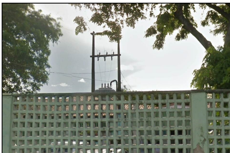
Subestação atual, de 225kVA em estrutura H
